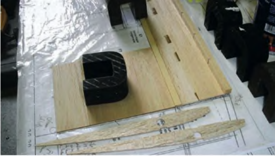
Der Holm und untere Beplankung liegen hier auf der Bauplan. Die Nasenleiste ist geschlitzt.
