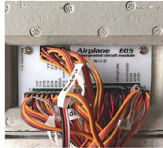
Der Kabelbaum am Integrated Circuit Module verwirrt nur im ersten Augenblick, denn jedes Kabel ist gut beschriftet.
