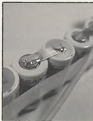
So sehen die Pole dann aus; was noch fehlt, ist die Verzinnung des gesamten Verbinders
