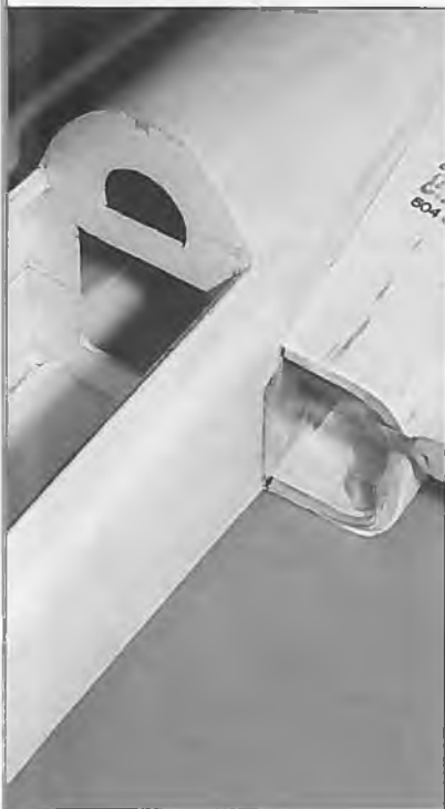
Nach dem Einkleben der Kanäle wird das überstehende Material am Einlauf abgeschnitten.
